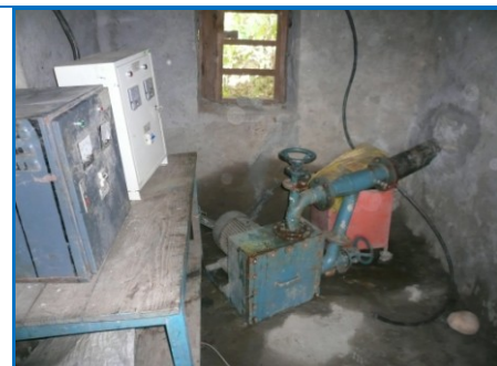
La turbine de l'installation hydroélectrique alimentant le village de Kuch
